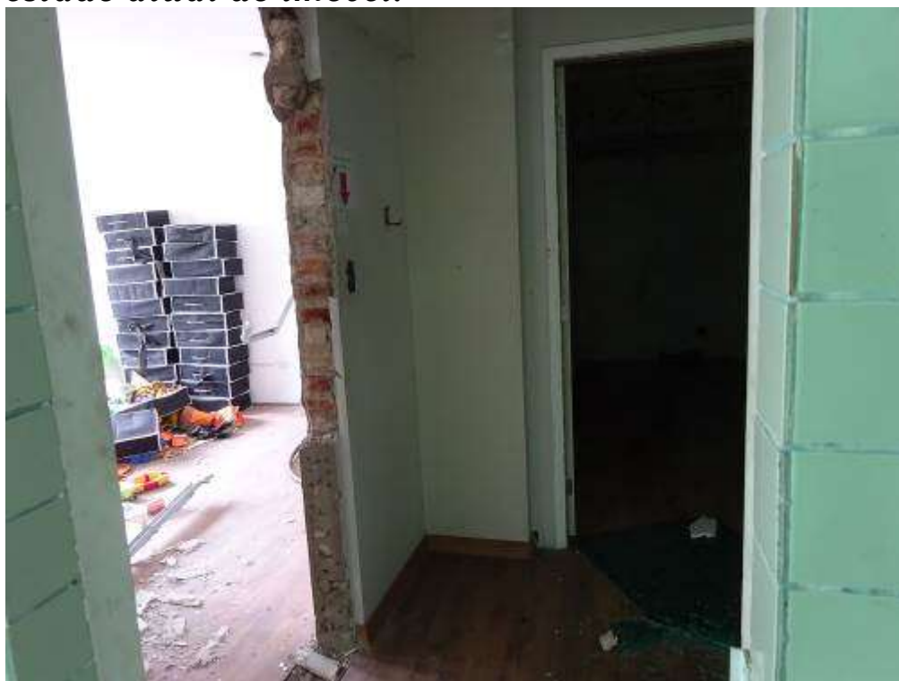
FOTO 07: Pavimento Mezanino: Vista parcial do péssimo estado atual do imóvel.
