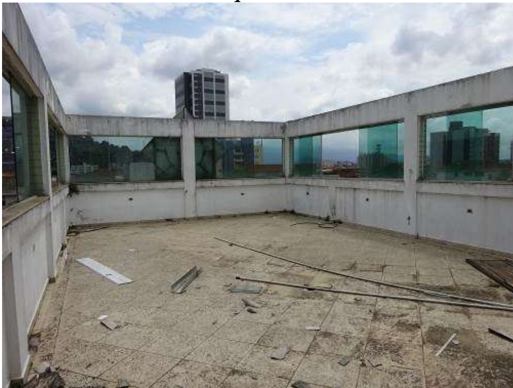
FOTO 14: Cobertura: Vista parcial de área descoberta.
