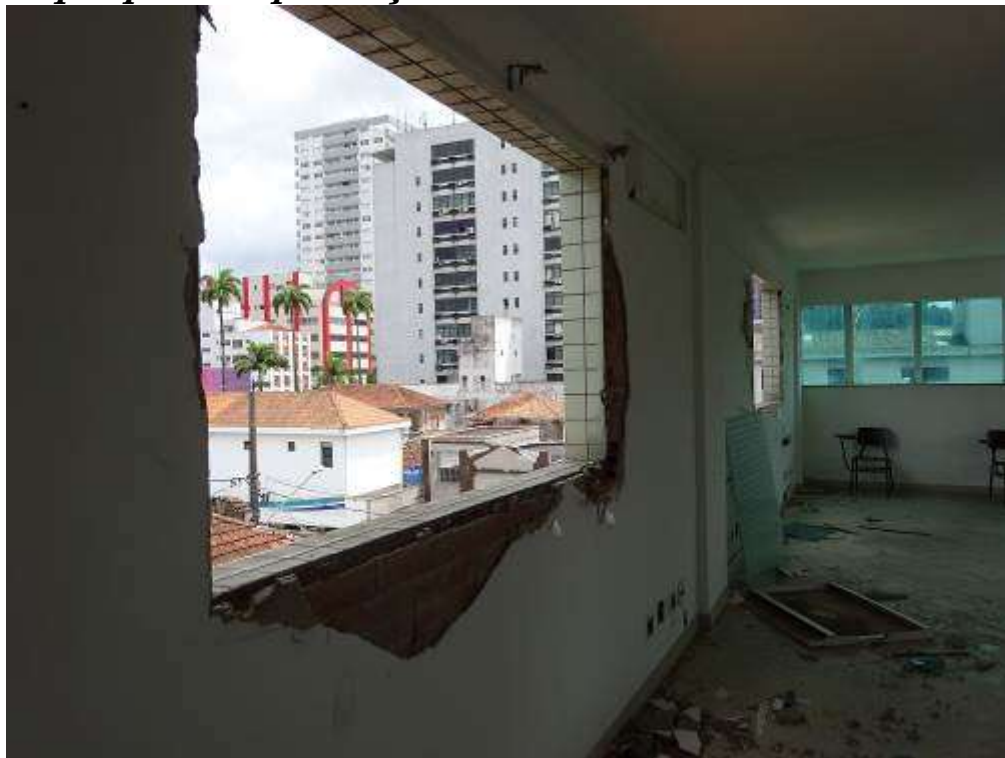
FOTO 12: Segundo Pavimento: Vista parcial de salão com destaque para depredação existente no local.
