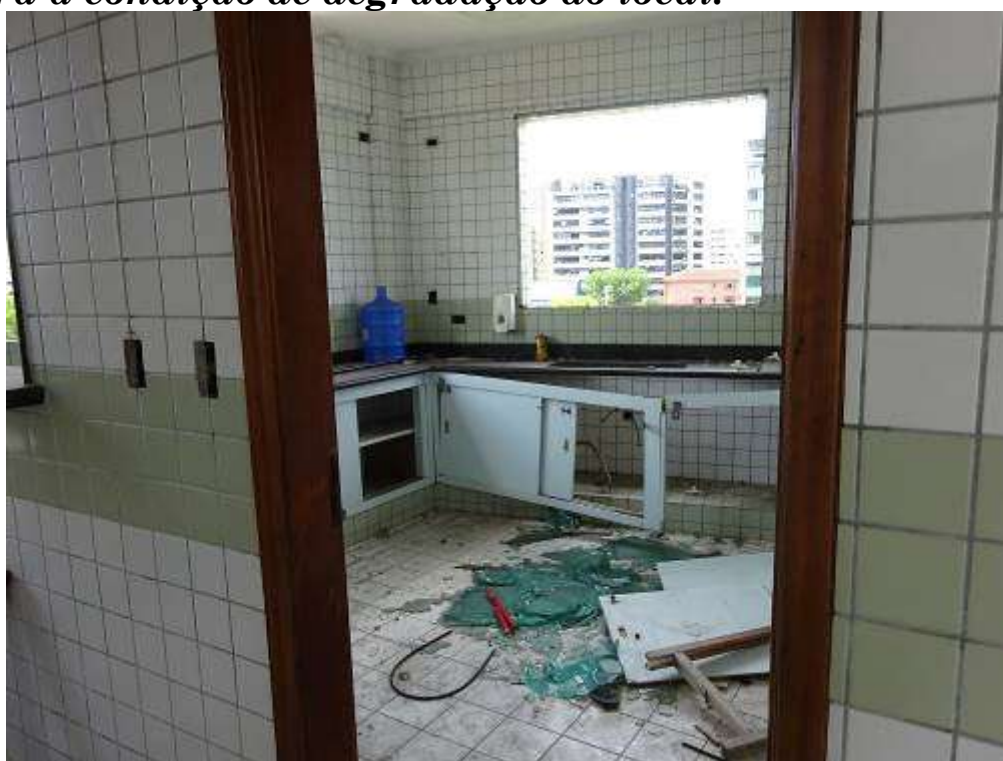
FOTO 15: Cobertura: Vista parcial da cozinha. Destaque para a condição de degradação do local.
