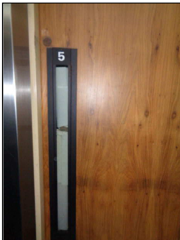
Foto 6: Elevador social no 5º andar com a porta bloqueada para o apto. 51
