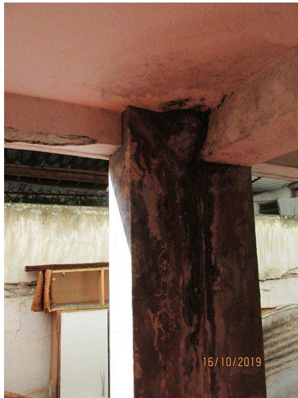
Foto 12 -- Área comum no térreo; graves infiltrações atingindo a estrutura do prédio
