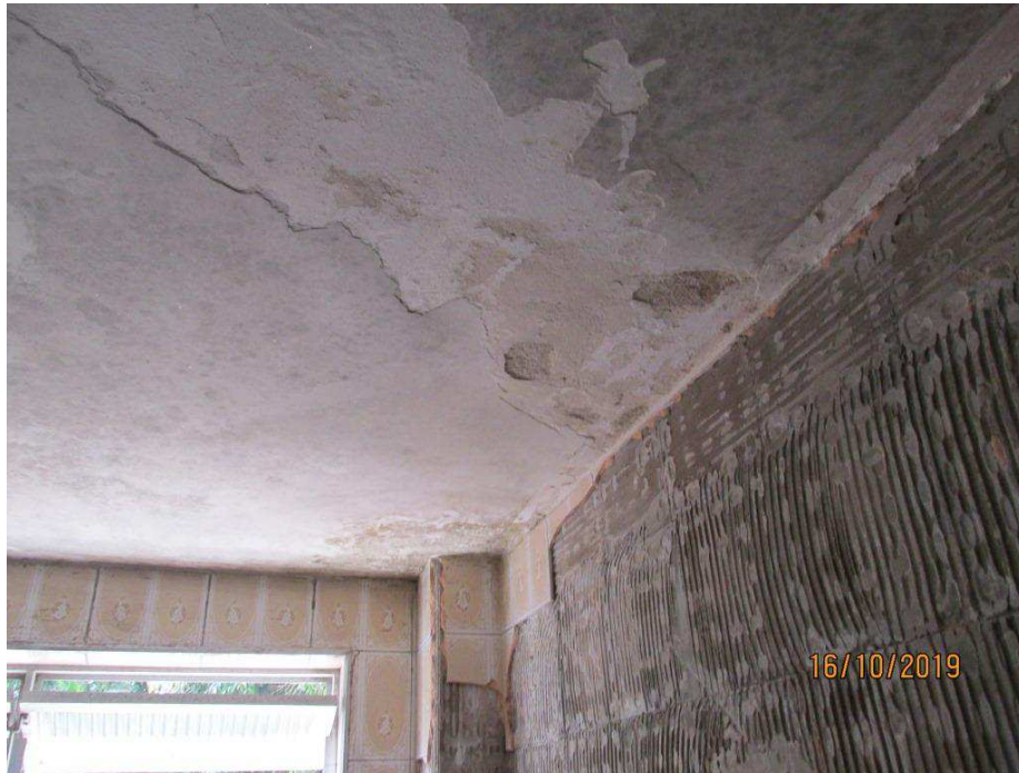
Foto 20 – Esboroamento do revestimento do teto do banheiro devido a infiltrações
