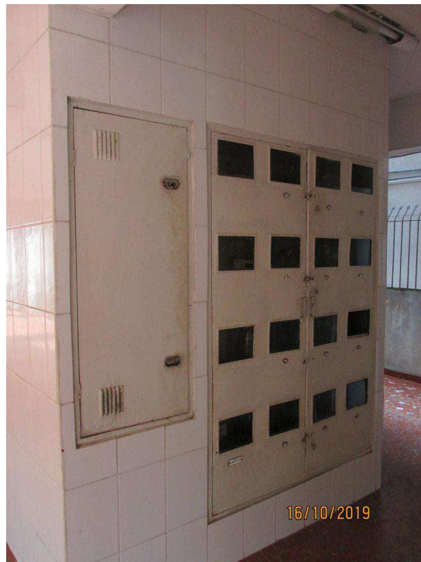
Foto 7 – Medidores de energia no térreo
