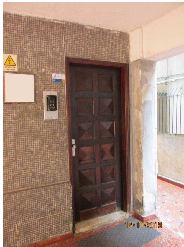
Foto 9 – Porta de acesso as unidades, inclusive aptº avaliando
