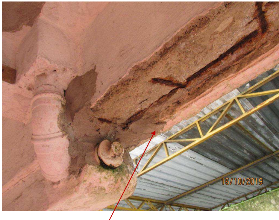
Foto 8 – Ferragens expostas na estrutura do prédio
