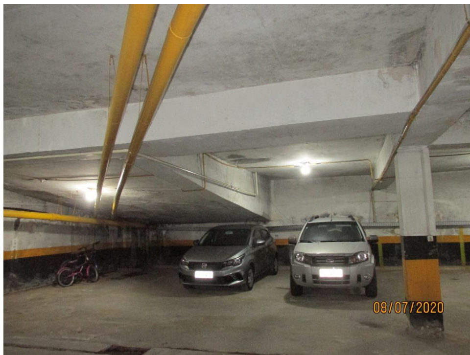
Foto 25 – Idem foto anterior, observando-se manchas no teto características de infiltrações
