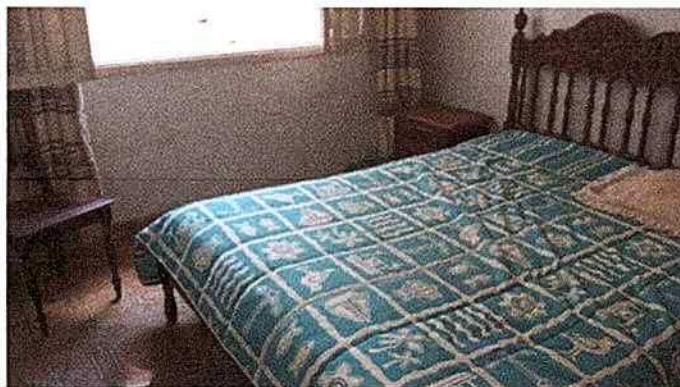
F 1: mostra parcial do quarto onde se observou destacamento do revestimento cerâmico do piso.
