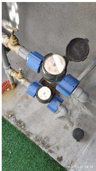
Cavalete de agua
