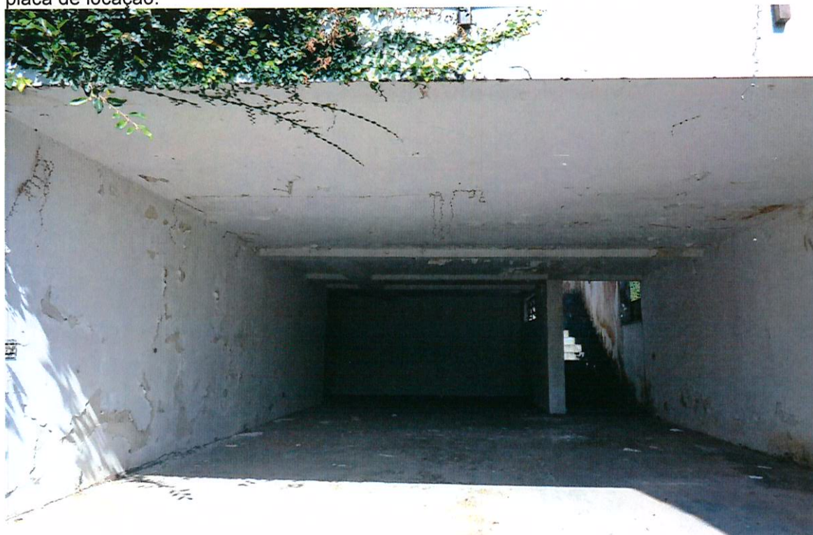
Vista da entrada da garagem com acabamentos deteriorados.
