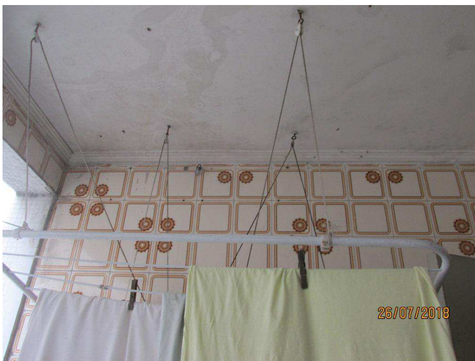
Foto 28 - Manchas de infiltrações no teto na área de serviço
