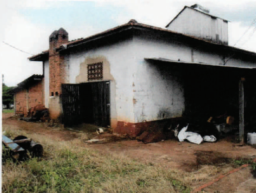
Foto 53 – Mostrando parte de um dos galpões rurais, e seu nível rústico de construção e de conservação.
