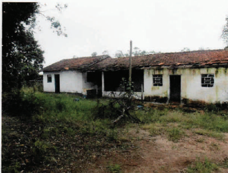
Foto 63 – Mostrando as antigas casas de colonos, todas abandonadas e em estado de deterioração, sem nenhum valor comercial.
