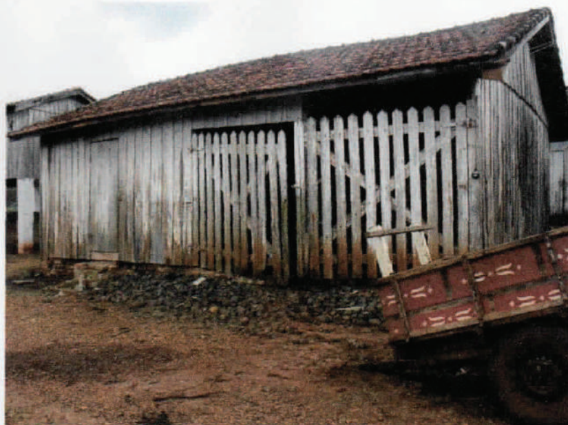
Foto 60 – Mostrando telhas de madeira, sem nenhum valor comercial na avaliação, pelo seu estado de conservação e nível de construção.
