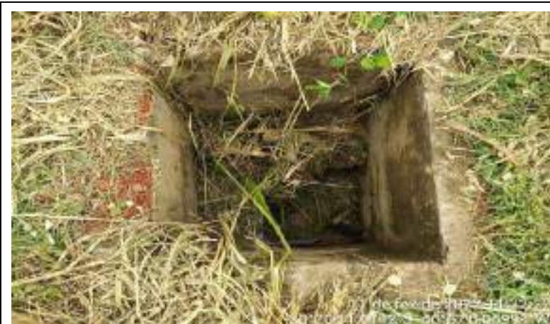
Foto 12 - Vista de caixa de passagem dos lotes (energia)
