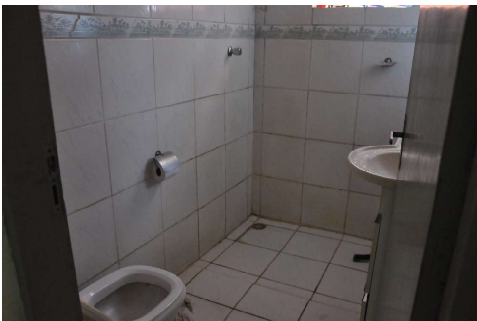
Figura 5 - Banheiro do imóvel avaliando.
