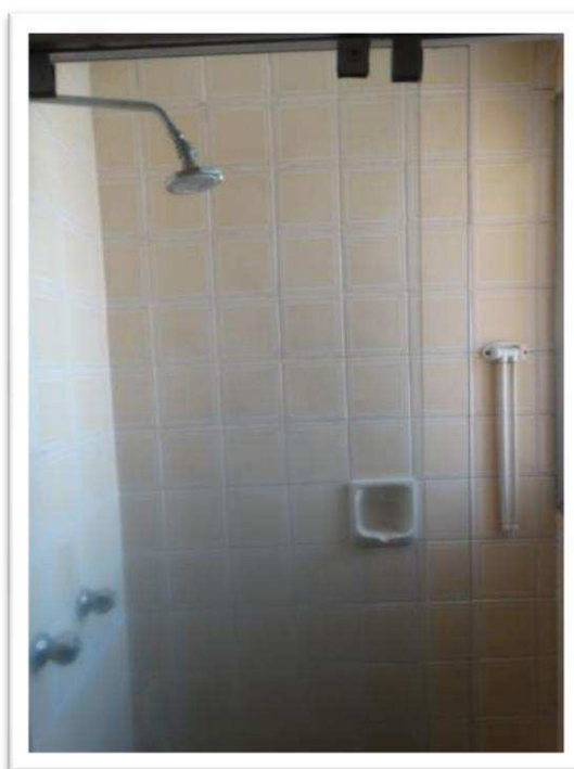
Foto nº 23 - Vista parcial interna do apartamento nº 111 do Edifício Via Colomba – Banheiro Social.
