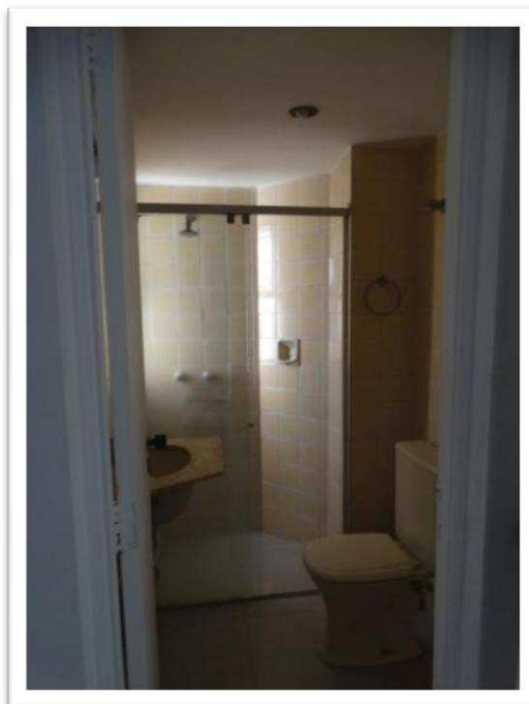
Foto nº 32 - Vista parcial interna do apartamento nº 111 do Edifício Via Colomba – Banheiro da Suite.
