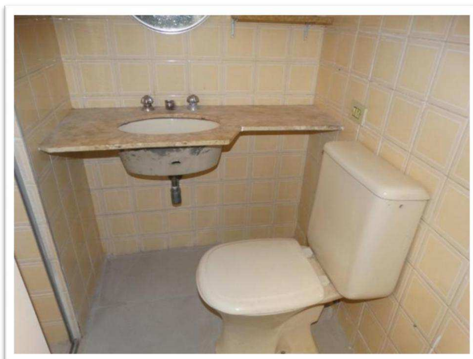
Foto nº 24 - Vista parcial interna do apartamento nº 111 do Edifício Via Colomba – Banheiro Social.
