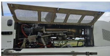
PP-MBP - MOTOR - VISTA LATERAL ESQUERDA (MANUTENÇÃO)
