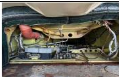
PT-HKL - COMPARTIMENTO DE EQUIPAMENTOS ELÉTRICOS
