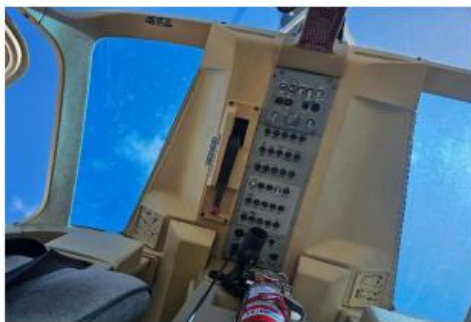
PP-MBO - PAINEL DE DISJUNTORES
