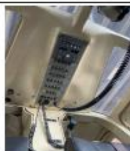
PT-HKL - PAINEL DE DISJUNTORES
