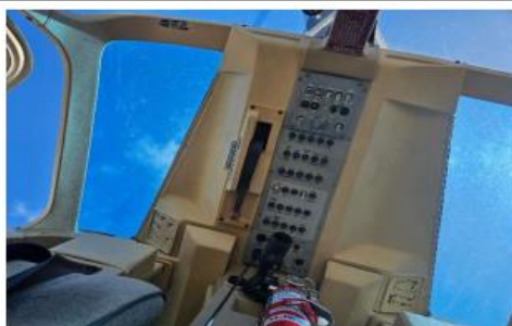
PP-MBO - PAINEL DE DISJUNTORES
