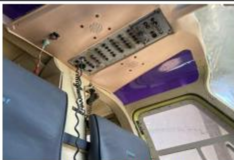
PT-HKK - PAINEL DE DISJUNTORES
